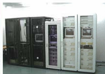
●サーバールーム
