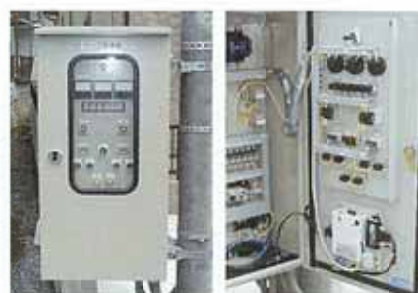
●TASK用監視盤 ●監視盤内部
