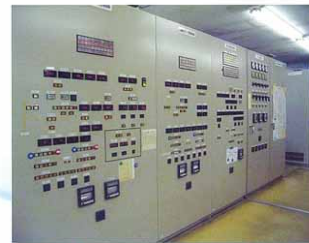
浄水場内の制御盤
