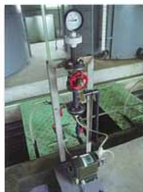
注入ユニット
