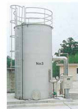
浄水場内のろ過機
