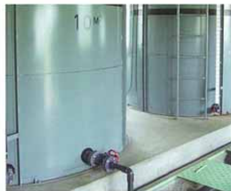
水処理薬品タンク
