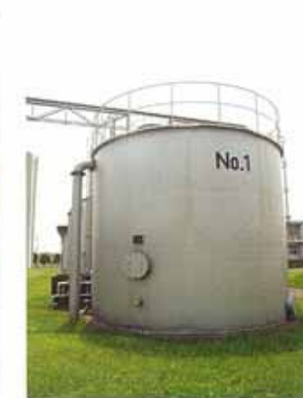
浄水場内のろ過機
