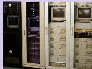
●サーバールーム
