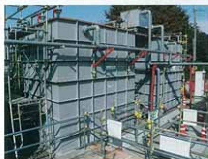
曝ろ過ユニット
