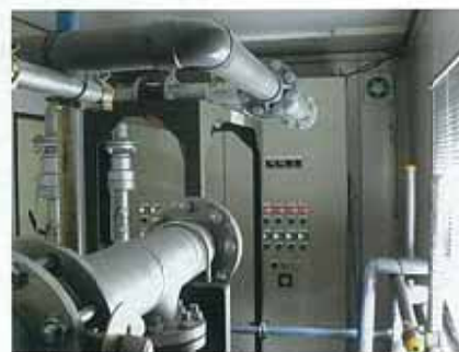
コントロール盤
