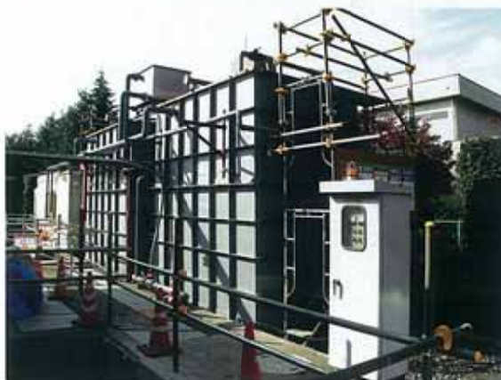
仮設可搬型排水処理ユニット
