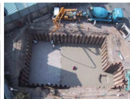
蓄熱槽設置状況
