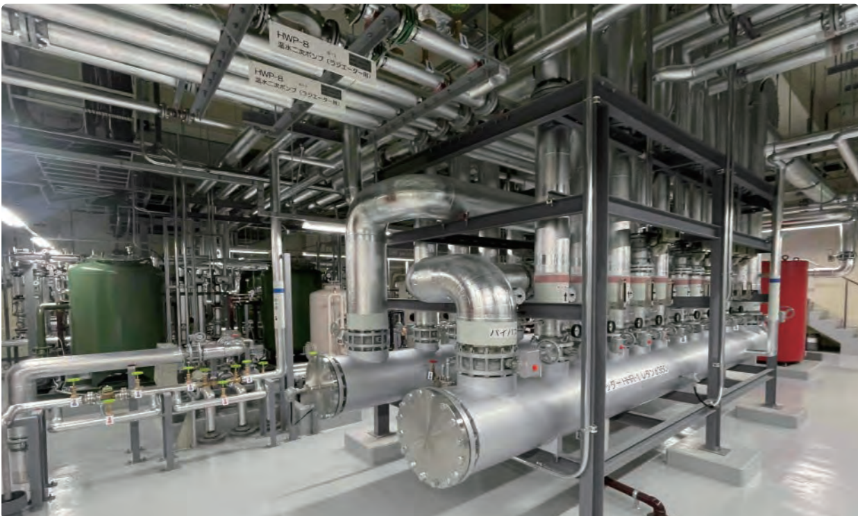
機械室のユニット
